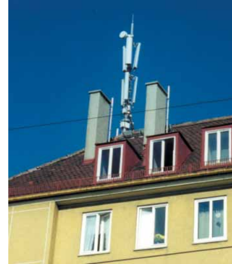
Die Mobilfunkanlage auf dem Dach kann den Wert eines Gebäudes mindern.
